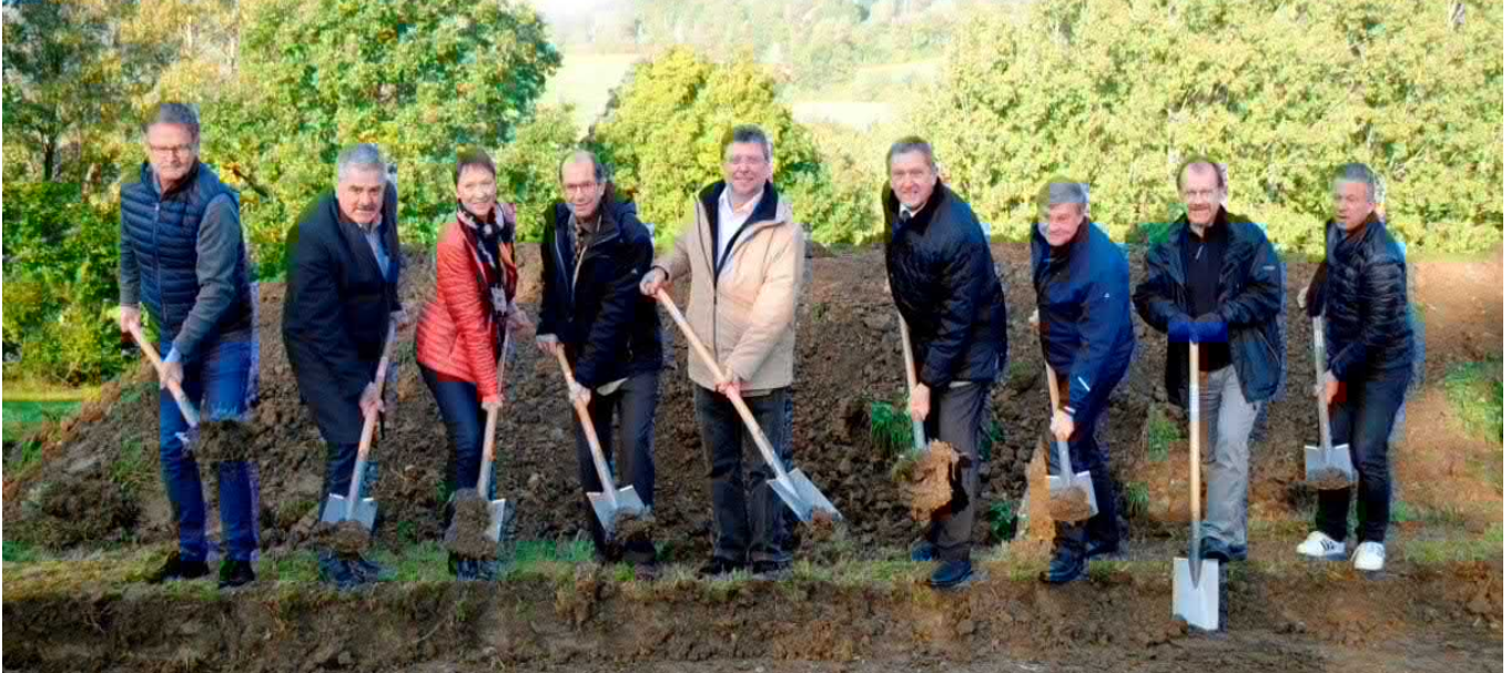
Die VG Weidenberg hat gemeinsam mit dem StBA Bayreuth und dem ALE Bamberg einen Wegebau von ca. 1,5 km Länge zwischen Döhlau und Untersteinach begonnen. Die Radwegverbindung wird zukünftig flacher verlaufen, da die größten Hürden im Höhenprofil entschärft werden konnten. (Spatenstich am 10.10.2016, Foto: Nordbayerischer Kurier – M. Kircher)
