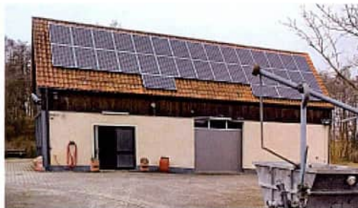
Abbildung 4.13 b: PV-Anlage (Dachanlage)
