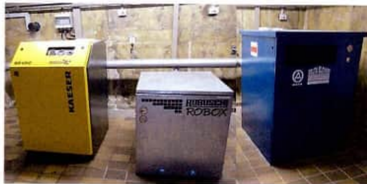
Abbildung 4.8: Drehkolbengebläse im Betriebsgebäude
