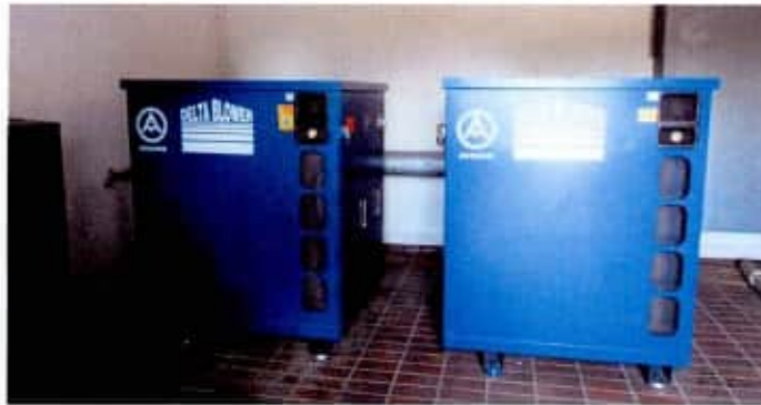
Abbildung 4.6: Drehkolbengebläse im Betriebsgebäude
