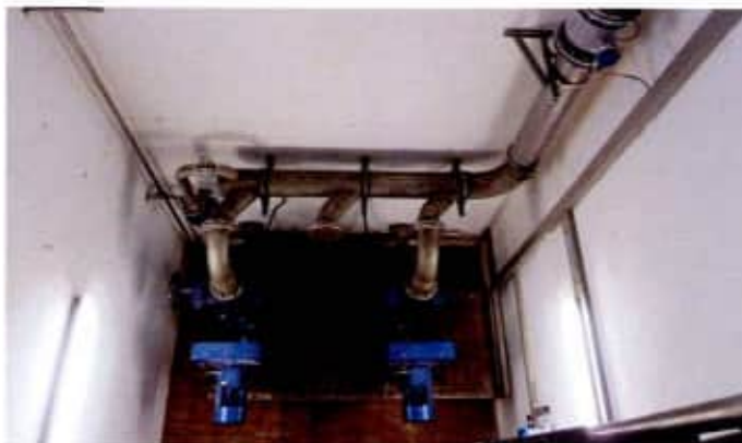
Abbildung 4.3: Zulaufhebwerk der KA Hollfeld
