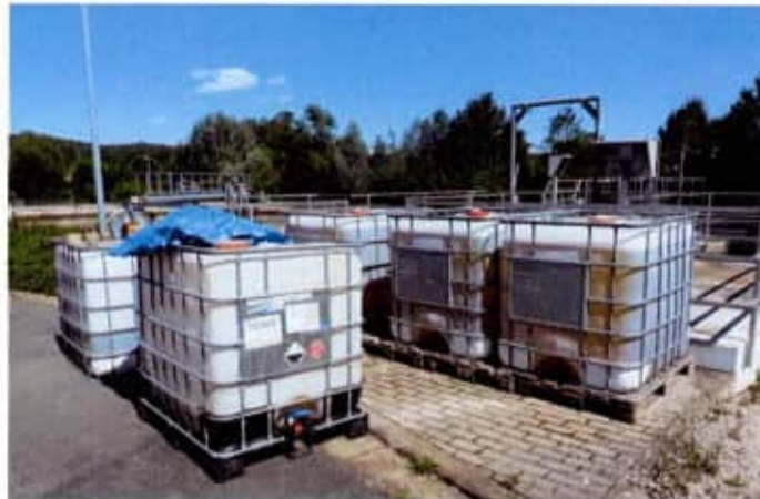
Abbildung 4.8: Provisorische Fällmitteldosierung der KA Hollfeld
